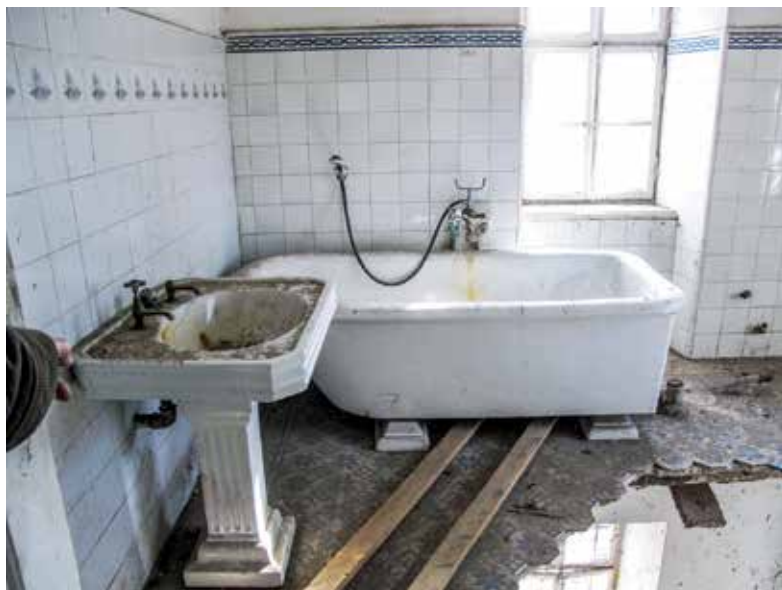
8 | Zarwany strop wraz z podłogą w jednej z pałacowych łazienek, 2010 r.
